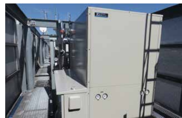
ヒートポンプ
