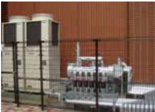
冷暖房システム室外機設置状況
