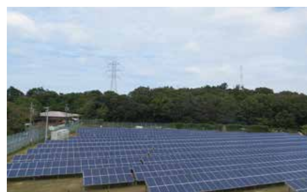
太陽光発電 西坂部
