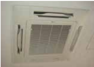
室内吹き出し口
