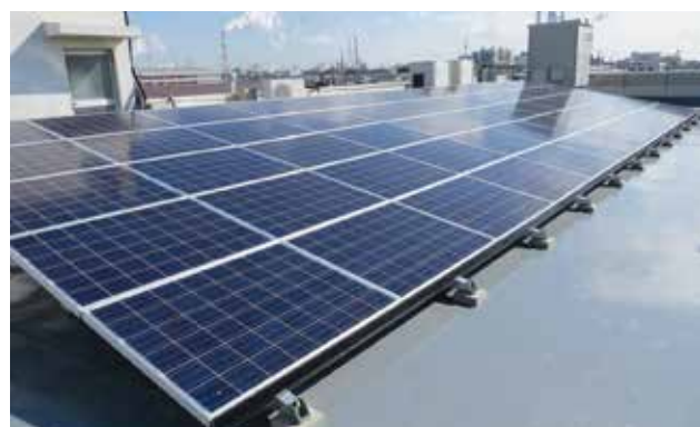
太陽光発電 本館
